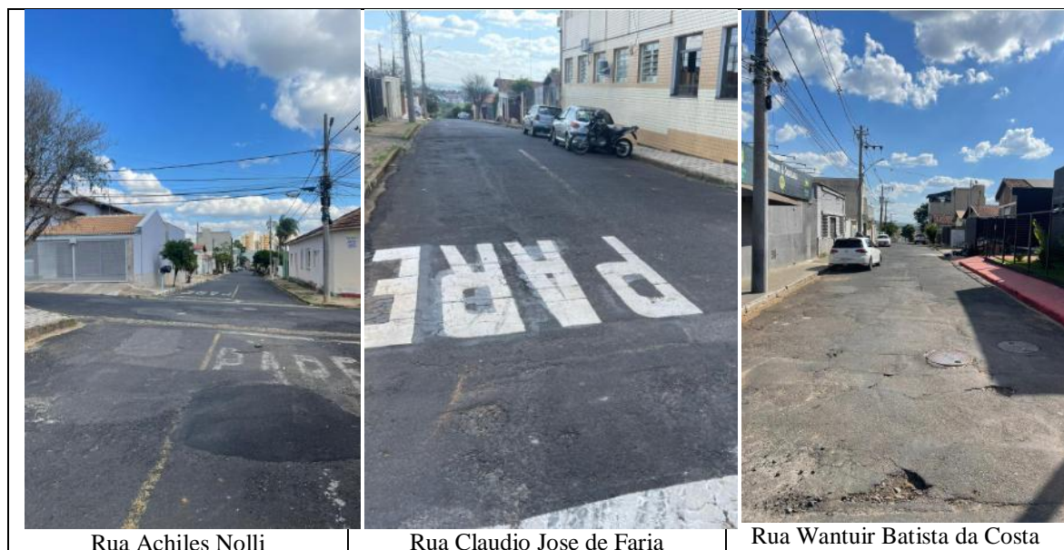
Figura 18: Situação do pavimento das vias de entorno do empreendimento.
